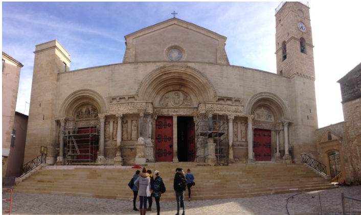
Visite du chantier de restauration de l'Abbatiale de Saint-Gilles du Gard (Cl. N.Villiermaux)
